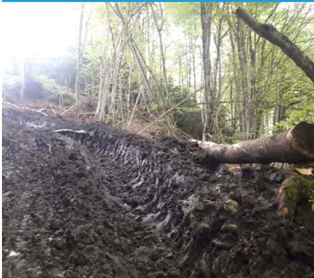
Portet d'Aspet - Captage Hontau : dégradation du chemin à proximité du captage
