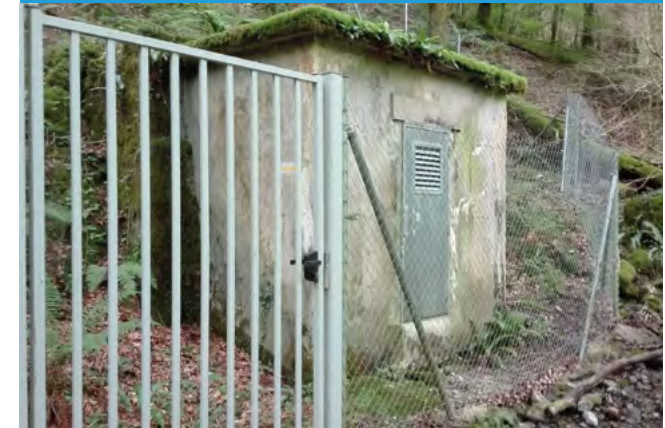
Arbas - Captage Poume Haute : captage avec porte et clôture
