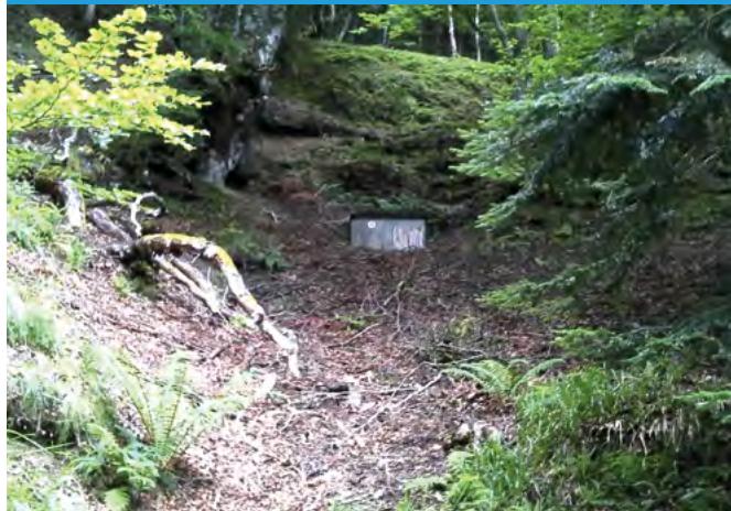
Boutx-Argut-Dessus : captage Goutilles
