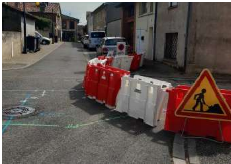
Signalisation route Barrée côté Rue Laurette
