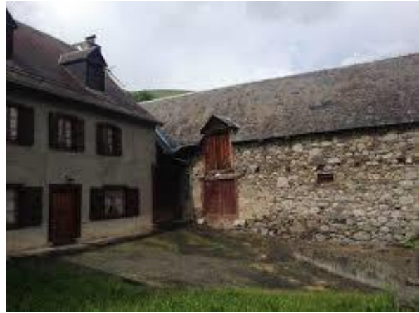
Toiture sans gouttière
