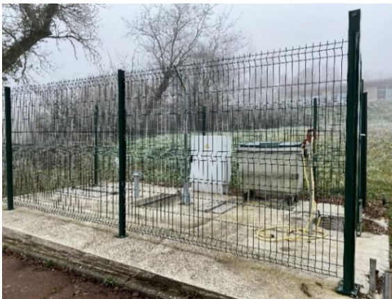
Poste de relevage sur le site de l'ancienne STEP
